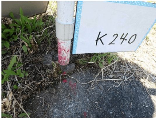
NO. 17 点名 K240 (割れたコン柱あり)
